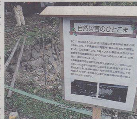
台風15号の被害で思わぬ発見となった石垣
